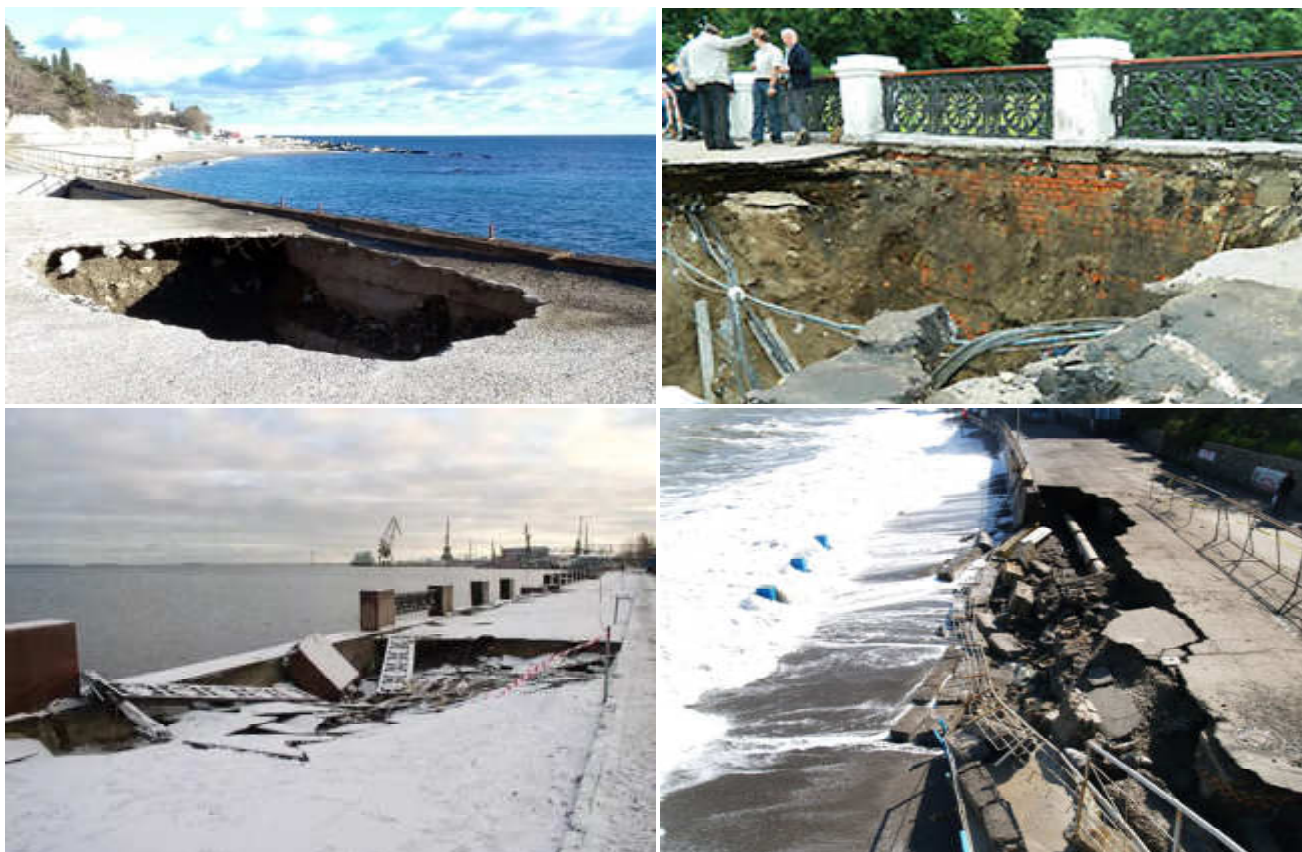
Фото 52-55. Размыв волнами и потоком воды набережных
