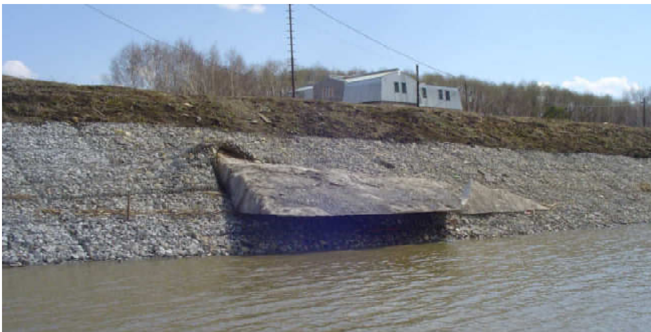
Фото 5. Повреждение габионных конструкций льдиной
