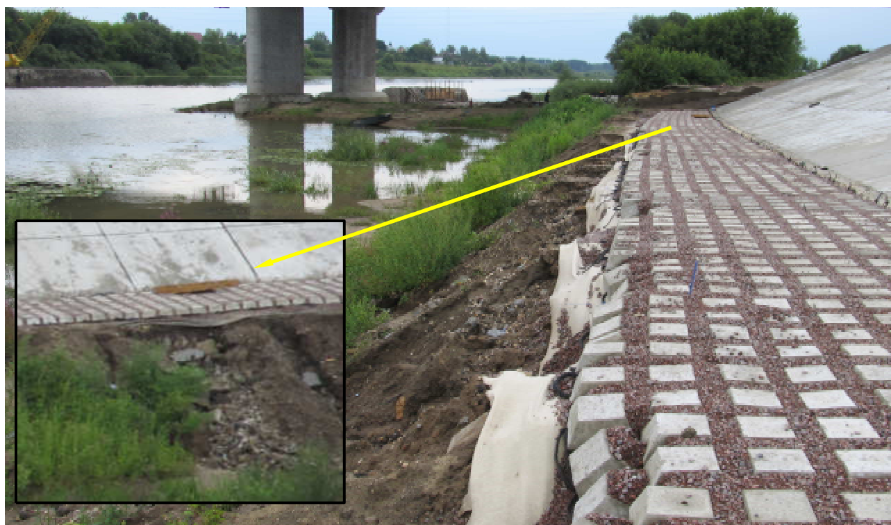
Фото 33. Недостаточная ширина «фартука» из ГБ-плит, приводящая к разрушению ГТС
