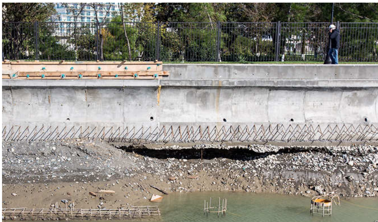
Фото 56. Размыв места примыкания ГТС с дном водоема
