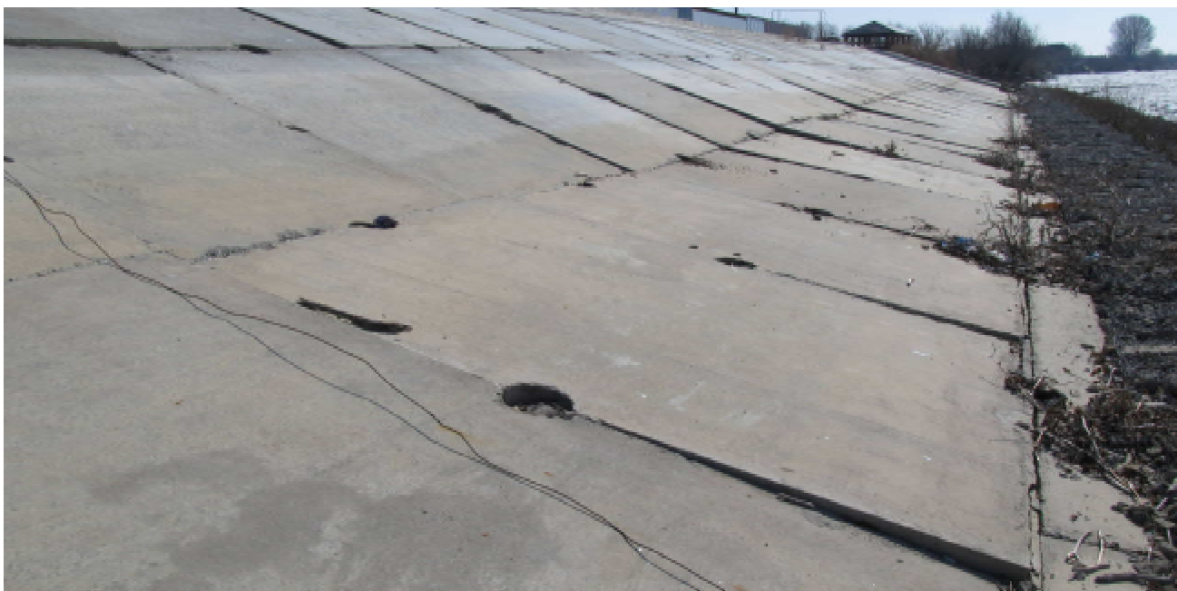
Фото 14. Проседание берегоукрепительного сооружения
