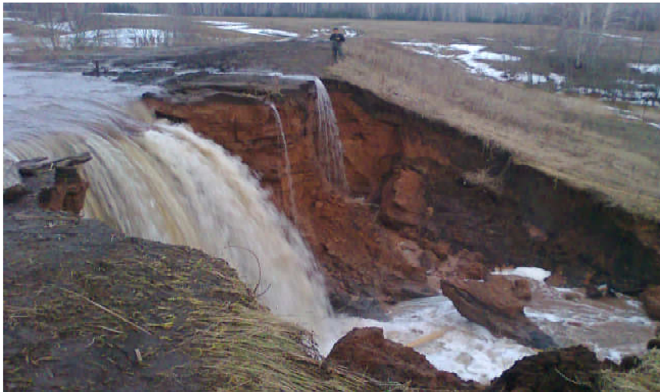
Фото 48. Разрушение грунтовой плотины
