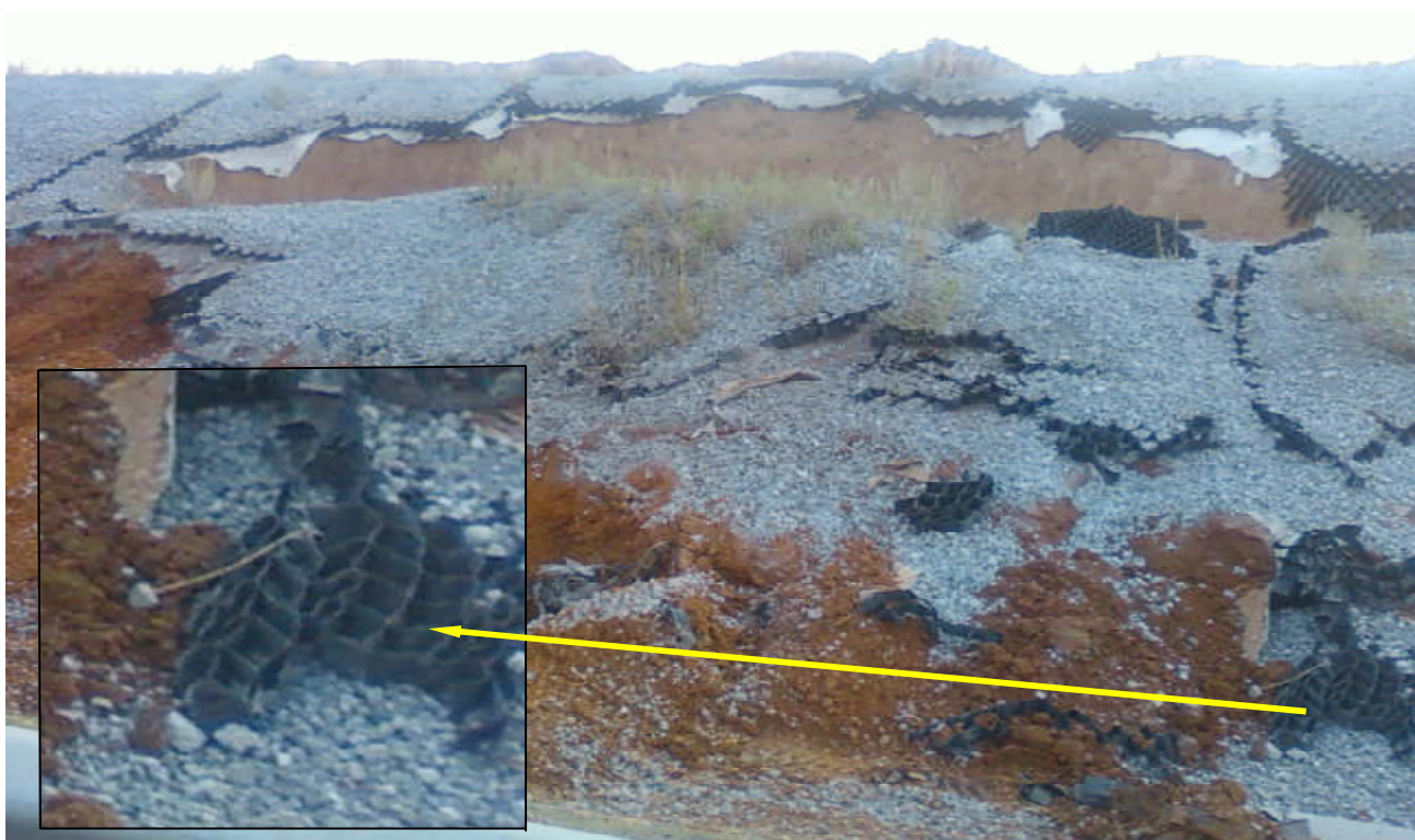
Фото 8. Разрушение защиты откоса, выполненного с применением георешоток
