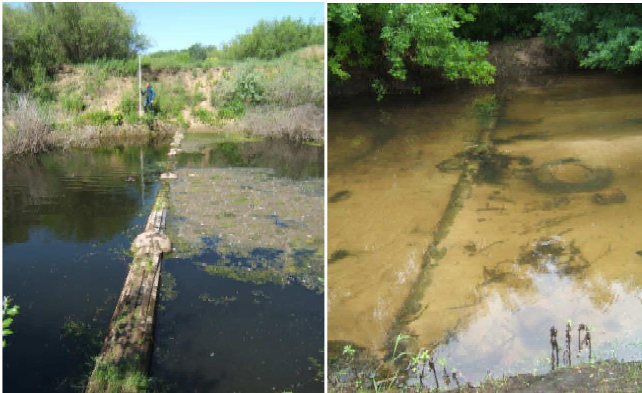
Фото 36 и 37. Размытый течением водотока трубопровод
