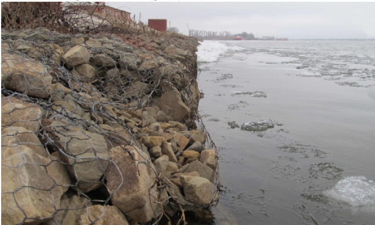
Фото 4. Поврежденная сетка габионных конструкций
