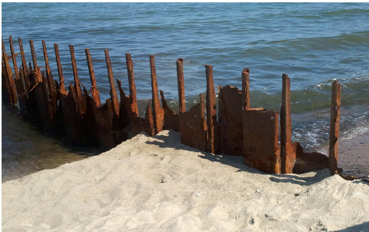
Фото 18. Разрушение шпунтовой подпорной стенки
