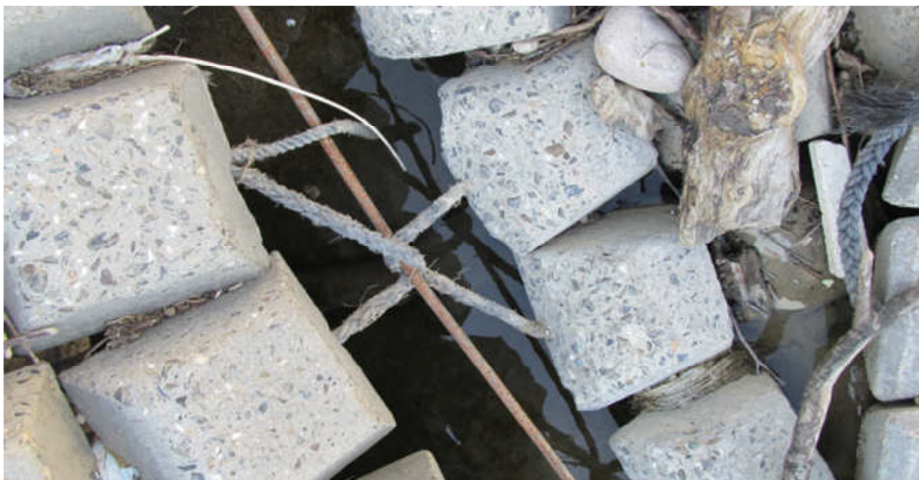
Фото 30. Истираемость бетонных блоков ГБ-плит в процессе эксплуатации
