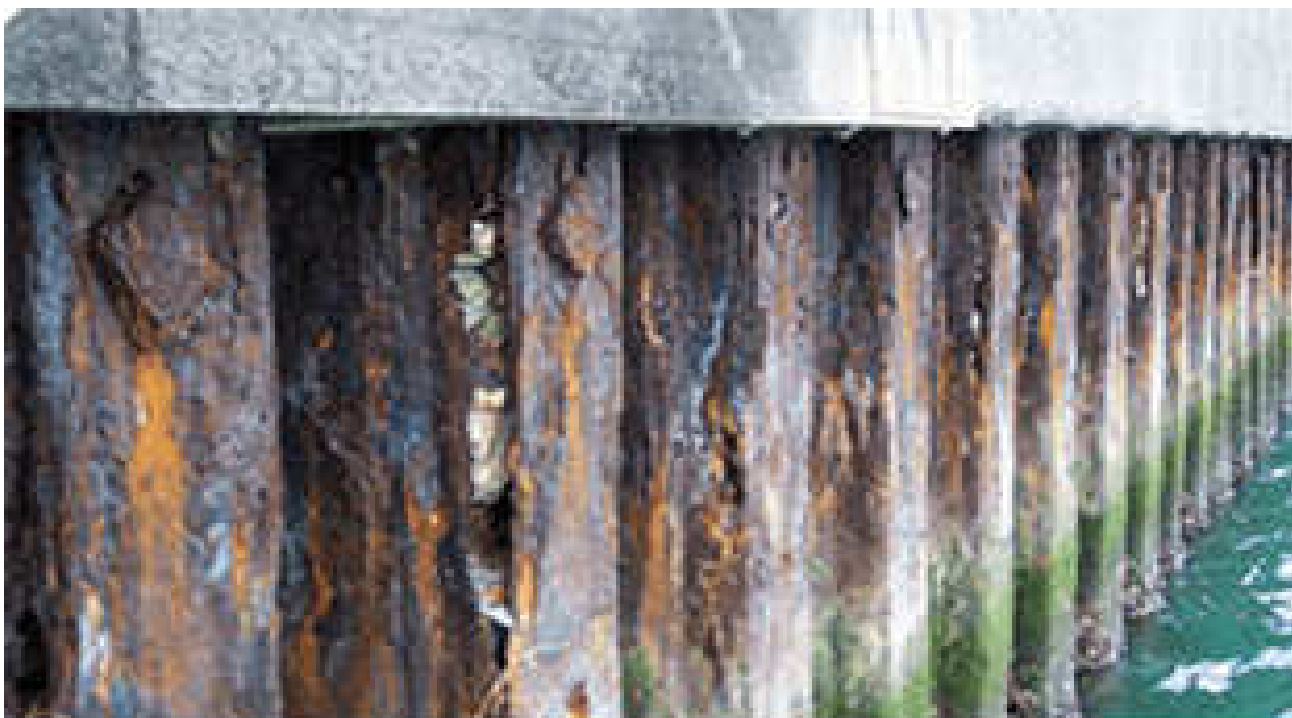
Фото 17. Коррозия металлических шпунтовых подпорных стенок
