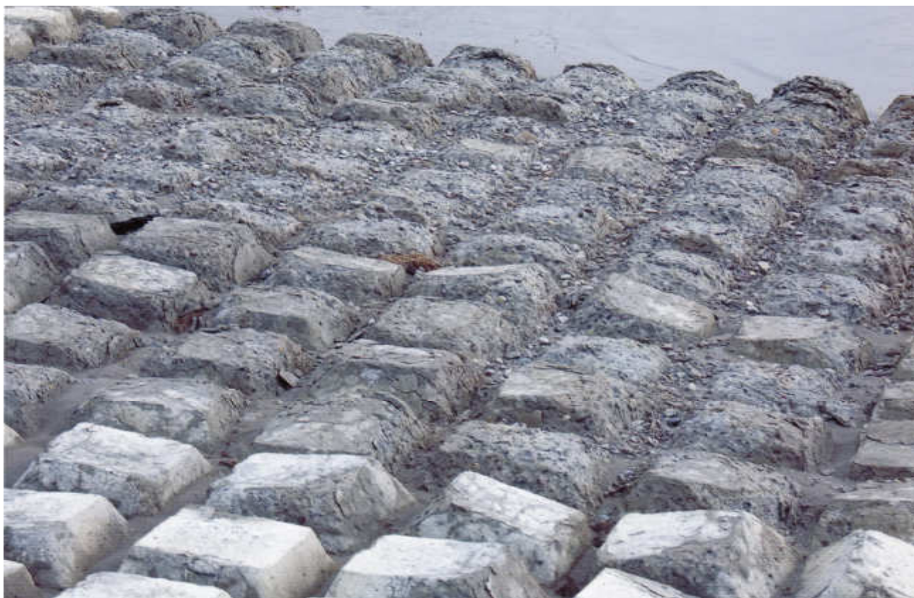
Фото 59. Контрафактные ГБ-плиты на объекте через два года эксплуатации
