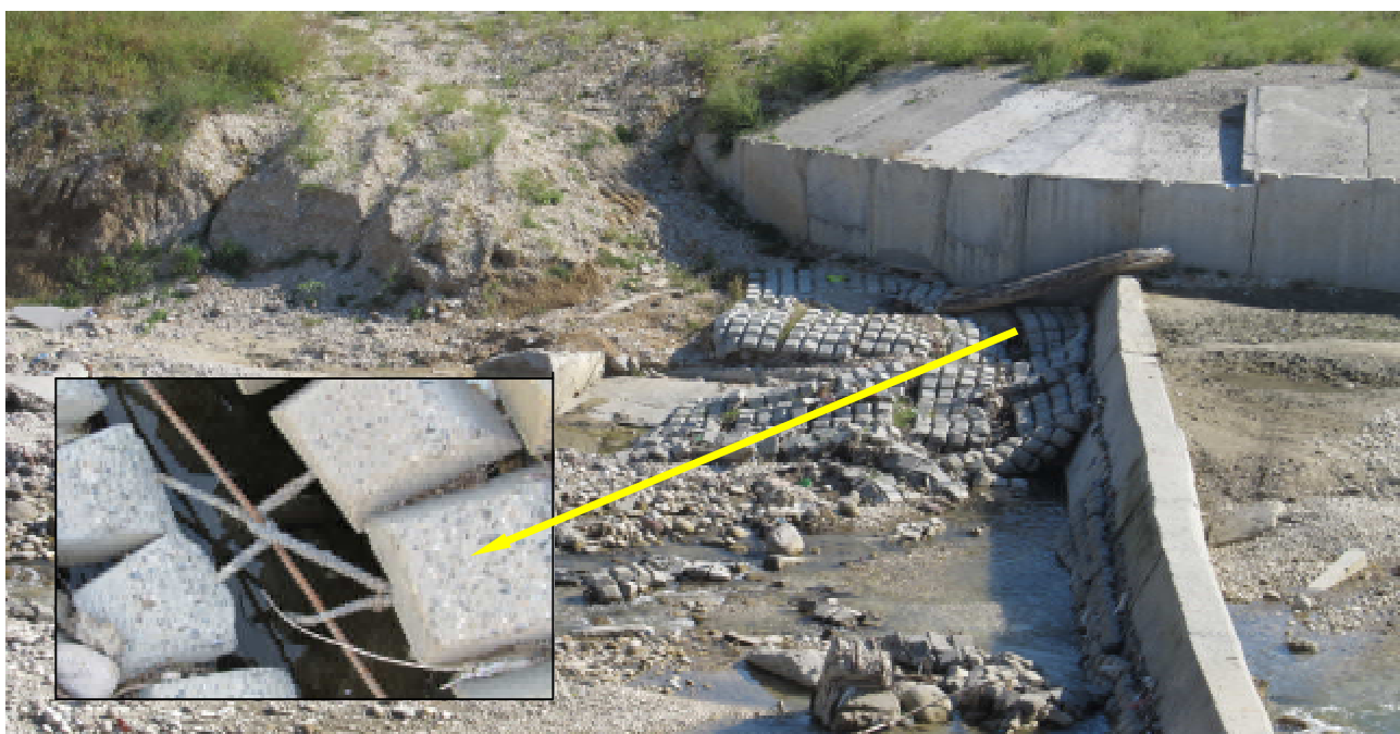
Фото 26. Последствия скрепления ГБ-плит за такелажные (монтажные, строповочные) петли
