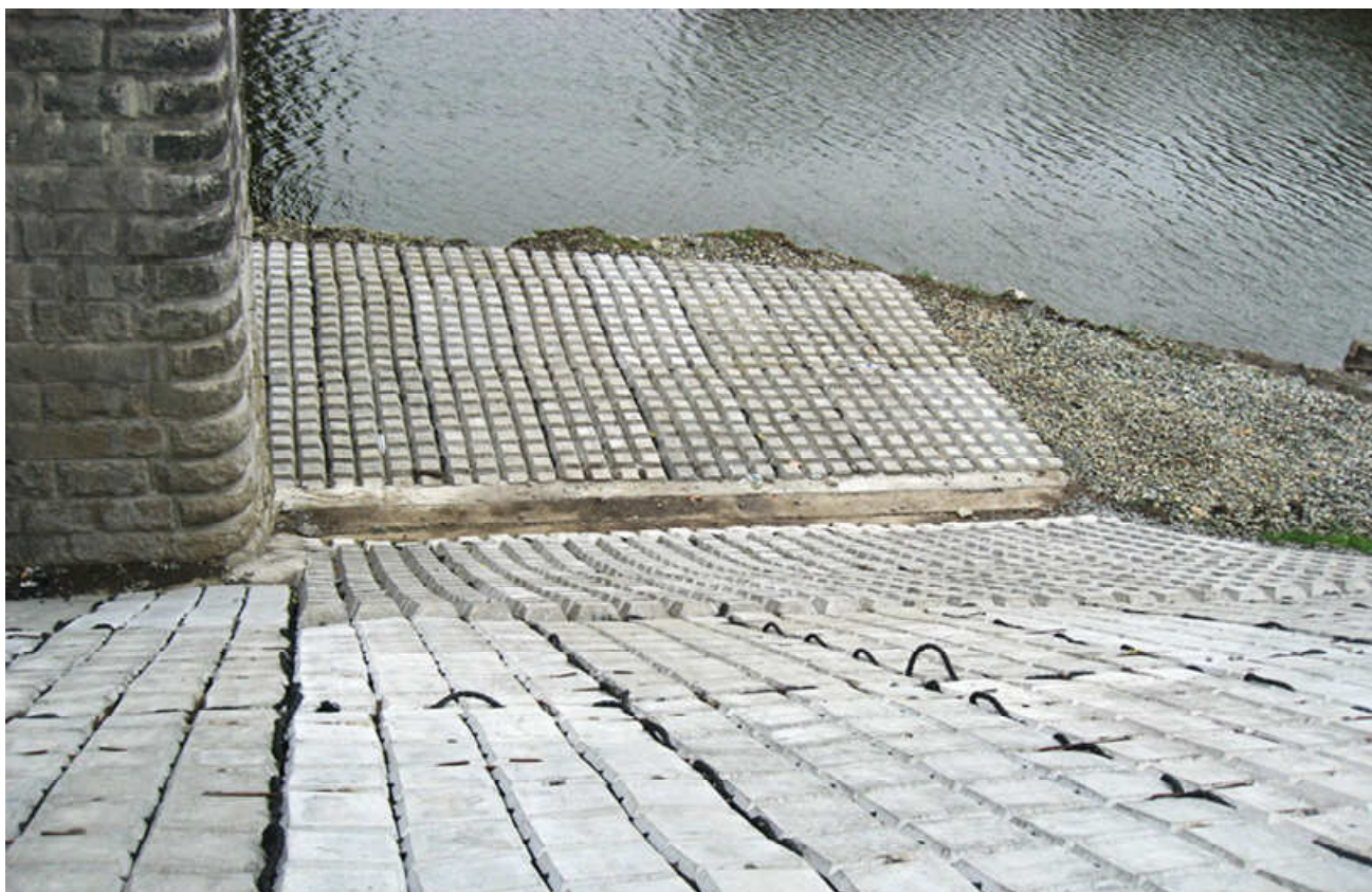
Фото 31. Нарушение пространственной ориентации ГБ-плит при укладке
