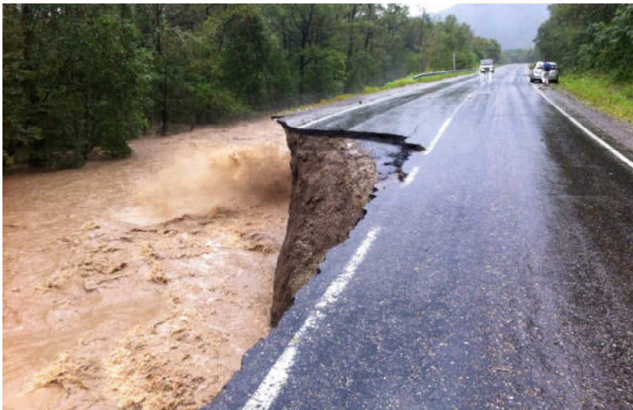
Фото 49. Разрушение насыпи дороги потоком воды
