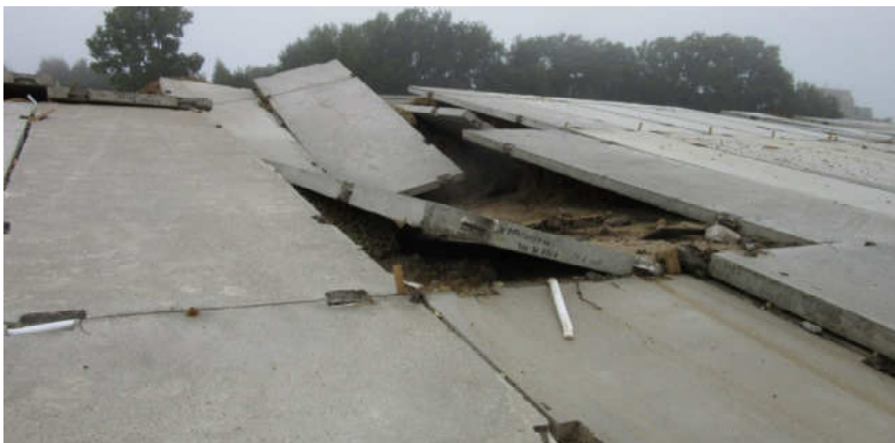
Фото 15. Обрушение берегоукрепительного сооружения
